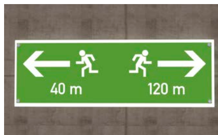
Befestigung Notausgangsschild in Tunnel
