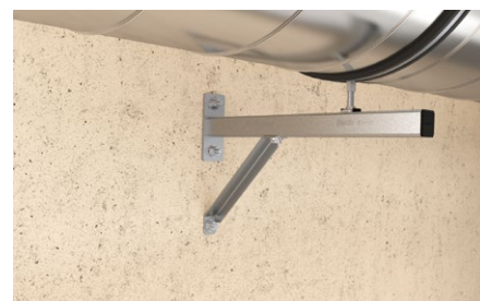
Canale di aerazione fissato su mensola a parete.
