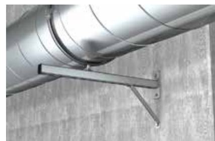
Canale d'aria fissato su mensola a parete
