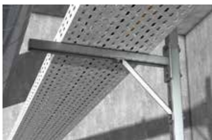
Canalina elettrica fissata su struttura a mensola
