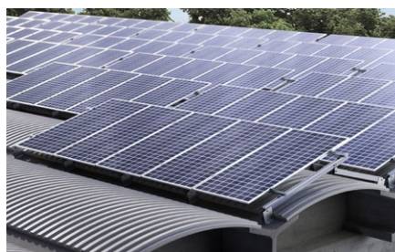
Impianto con orientamento SUD.
