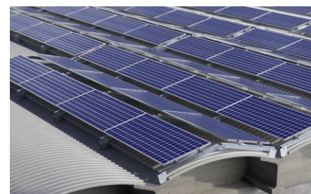
Impianto con orientamento EST-OVEST.
