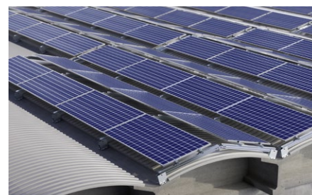
Impianto con orientamento EST-OVEST.
