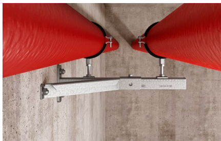
Controventamento orizzontale tubazioni.
