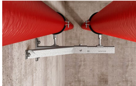
Controventamento orizzontale tubazioni.
