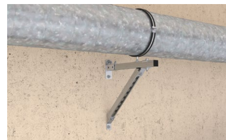
Strutture di supporto per sistemi di ventilazione.
