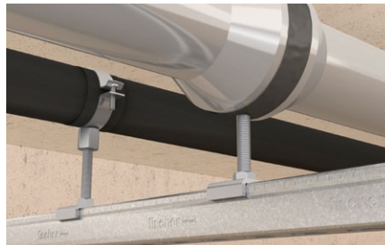
Tubazioni termicamente isolate su mensole.
