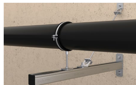
Tubazione pesante su mensola.
