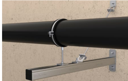
Tubazione pesante su mensola.
