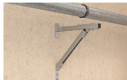
Tubazione sostenuta su telaio.
