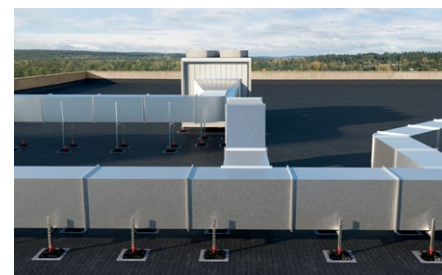
Strutture di supporto per sistemi di ventilazione.
