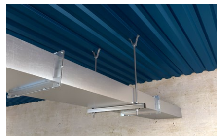
Condotta di ventilazione su lamiera grecata.
