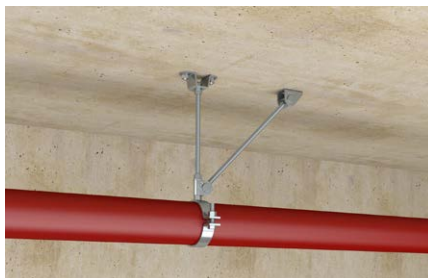
Linee di distribuzione con dilatazione termica.
