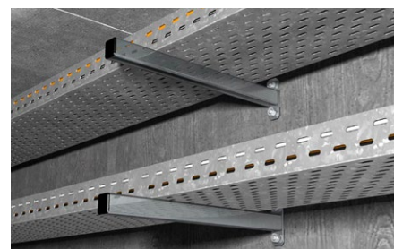
Mensole per canaline portacavi.
