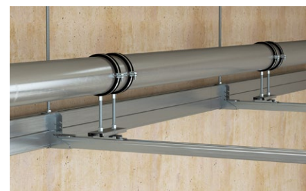
Linee di distribuzione con dilatazione termica.
