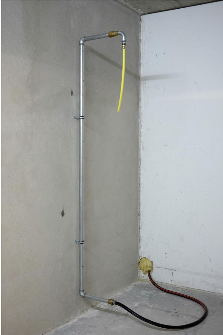
Abbildung 2: Trinkwasserleitung befestigt an der Installationswand
